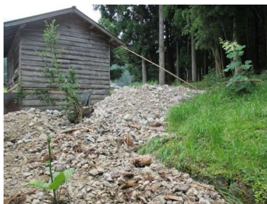
山林からの土砂流出 (H30(2018)年災)
