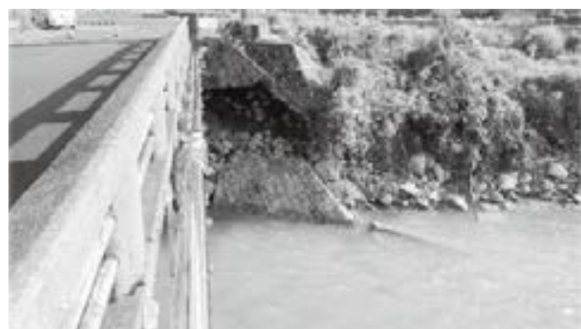
▲岸野地内 岸野橋橋台損壊
