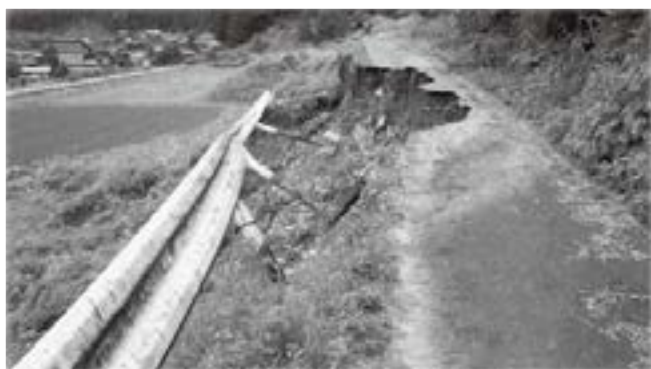
▲中原地内 農道損壊
