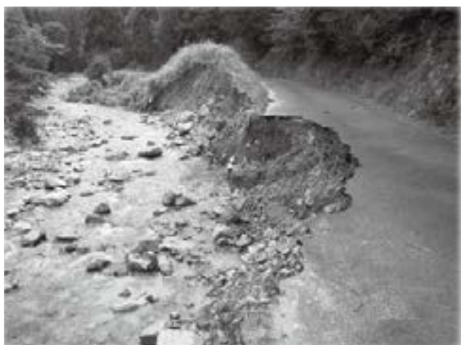
▲中原（加地）地内 林道損壊
