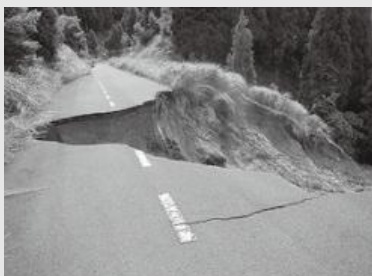
▲林道(加地)の被害状況
