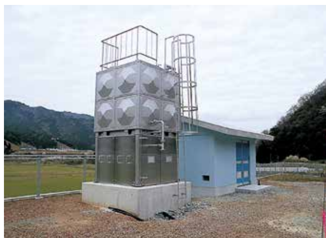
▲赤松地区：加圧ポンプ施設
