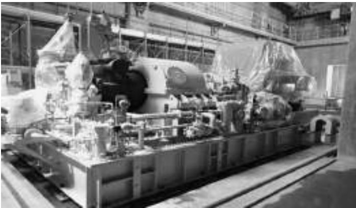
▲蒸気タービン発電機
