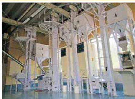
▲9月から稼働開始した若桜町精米施設内
