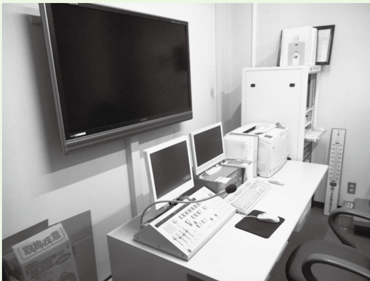
更新される防災行政無線機（庁舎内）
