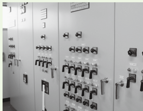
若桜浄化センター(電気制御装置)
