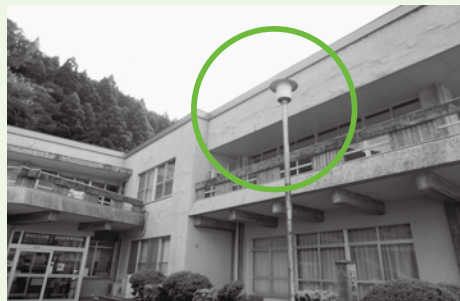
外壁劣化が激しい若桜町公民館
