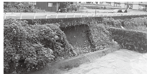
崩落した町道脇の護岸
