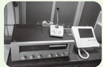
集落内放送設備
