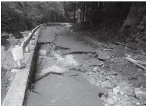
被災した林道
