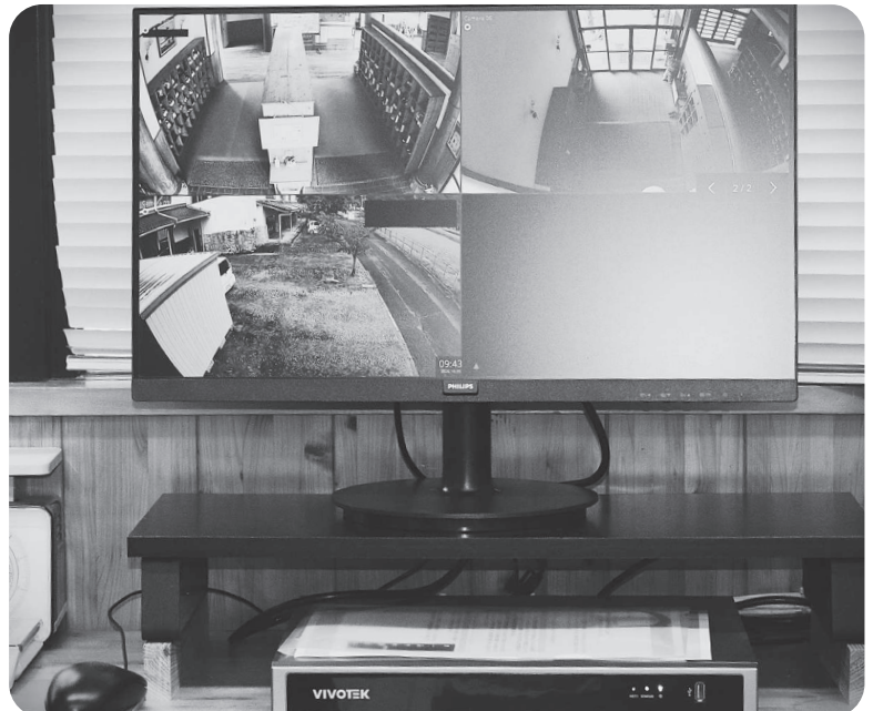
防犯カメラの画像を記録するモニター・レコーダー（若桜学園）
