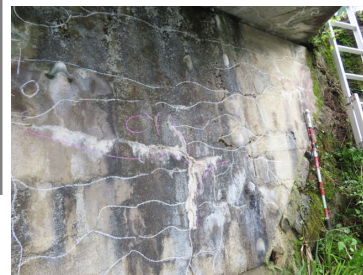
コンクリートのひびわれ
